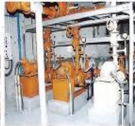
▲二次ポンプ室
