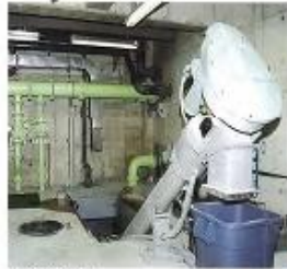
▲一次ポンプ室
