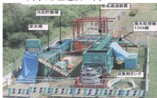
濁水処理施設の例
